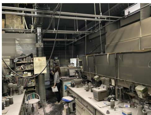
火災翌日の研究室の様子
